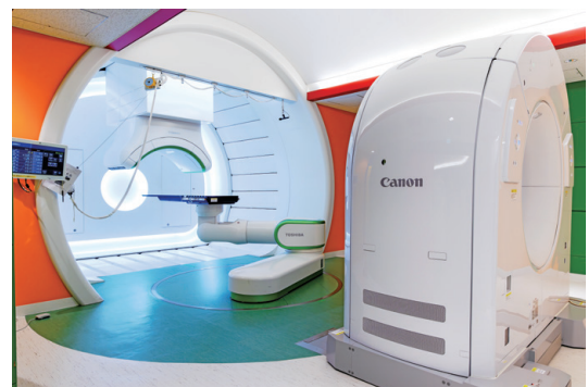
▲ 自走式 CT 装置を導入した回転ガントリー照射室
