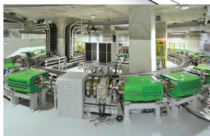
地下1F 加速器室
